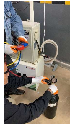
Ein Bild aus dem Klimaanlagekurs
